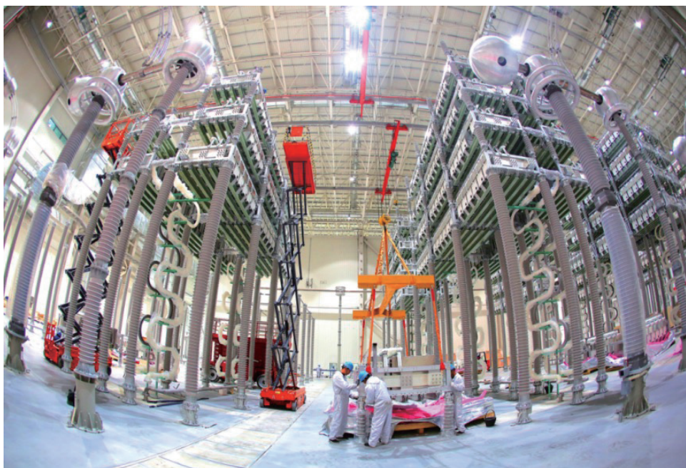
图3 张北柔性直流电网示范工程及柔性直流输电装备（二）
